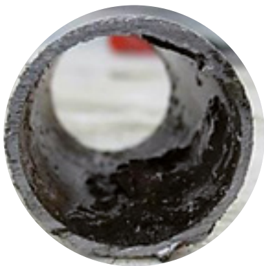
Kontaktkorrosion im Rohr
