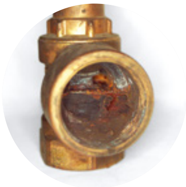
Rostablagerung im Ventil
